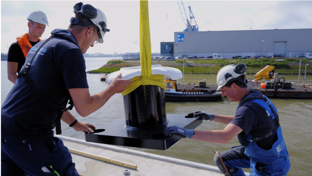
Installatie slimme bolder op een kade van de Maasvlakte
