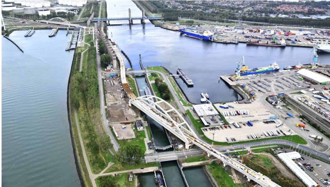
Twee stalen boogbruggen verhuisden van hun voorbouwlocatie naar hun definitieve plekken in het Theemswegtracé
