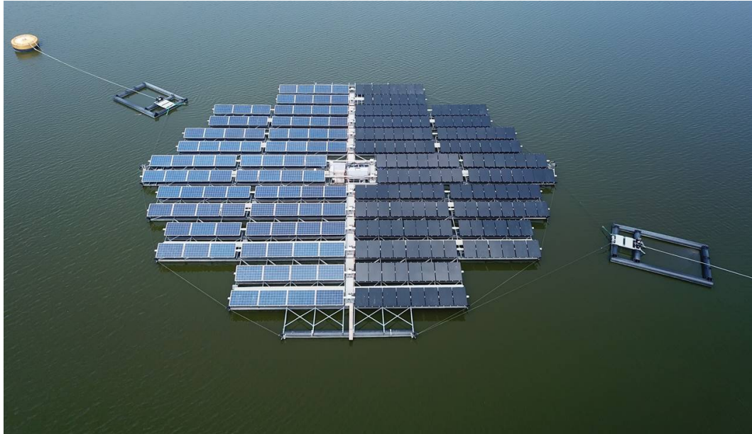
Zonnepanelen op de sluffer
